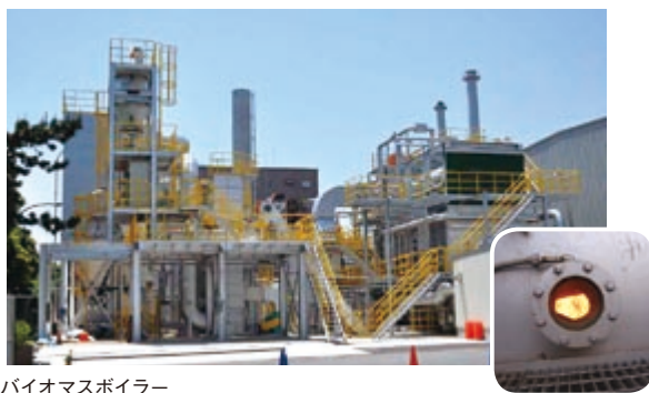
バイオマスボイラー
