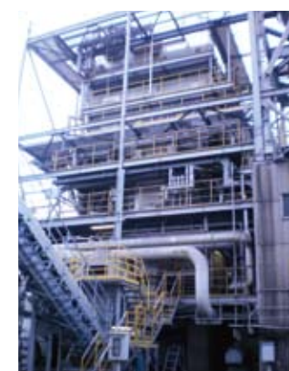
自家発電設備
