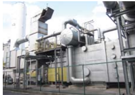
神戸工場 コージェネレーション設備
