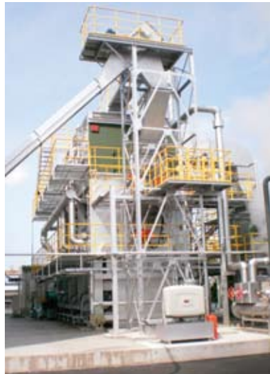
バイオマスボイラー
