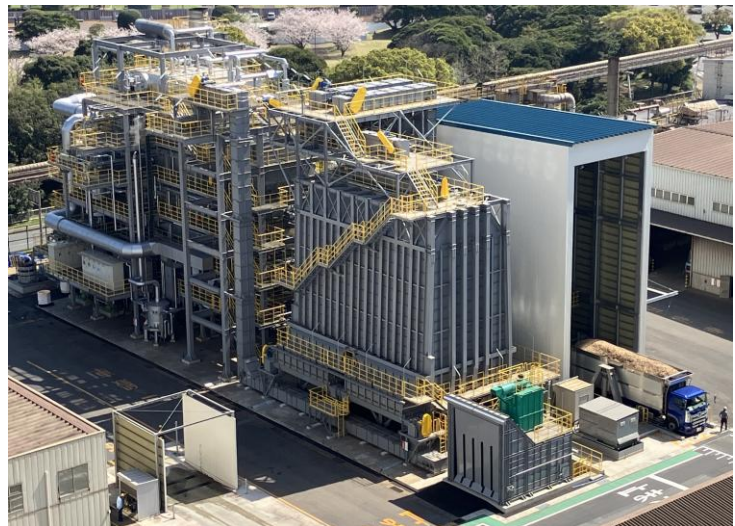
＜鹿島工場 バイオマス発電ボイラー外観＞
