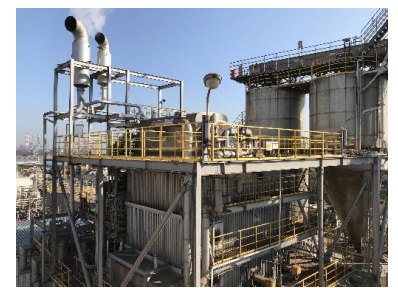
【コージェネレーション設備】
