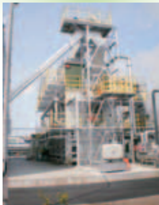
バイオマスボイラー
