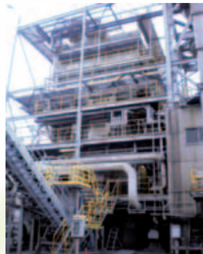
鹿島工場の自家発電設備
