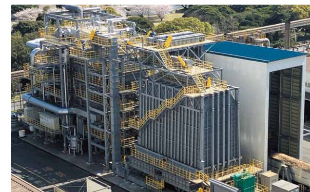
鹿島工場 バイオマス発電ボイラー
