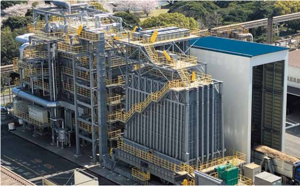
鹿島工場 バイオマス発電ボイラー 2026年4月稼働開始したバイオマス発電ボイラーは、木質チップなどの再生可能エネルギーを活用した設備であり、既存設備における都市ガス使用量を削減し、CO 2 排出量の低減に寄与するものです。
