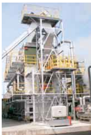
バイオマスボイラー
