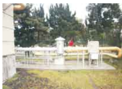
都市ガス受け入れ配管 (流量計及び遮断弁)
