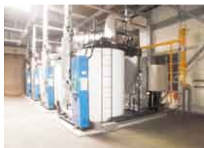
小型ボイラー熱源
