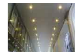
本社ビルLED照明
