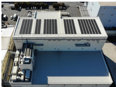
【船橋プレミックス第2工場屋上に設置した太陽光発電設備】
